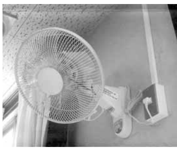
設置された扇風機
